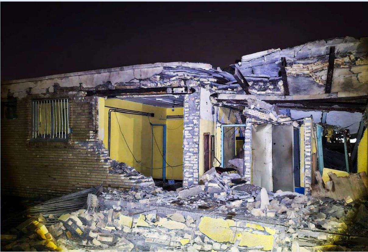
أضرار في مبنى تعرض لضربة أمريكية في كوهستاك جنوبي إيران فجر الأربعاء
